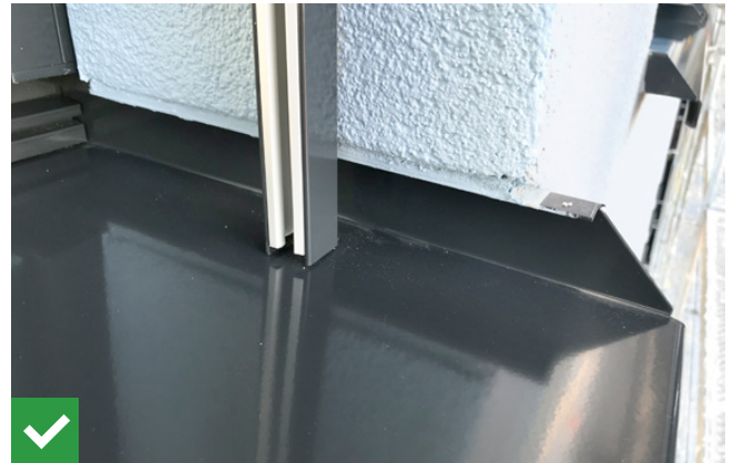
Abb. 11 Putzbordanschluss mit sichtbarem Fugendichtungsband mit Farbe beschichtet
