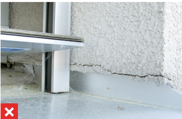
Abb. 42 Unkontrollierter Putzabbriss aufgrund des fehlenden Trennschnitts bei starrem Putzbord
