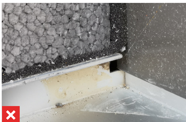
Abb. 64 Bei der Ausklinkung fehlt die Fugenflanke. Eine Abdichtung kann daher nicht angebracht werden.
