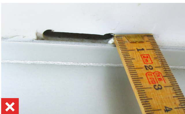
Abb. 30 Entwässerungsöffnung wird durch hinteren Aufbug teilweise verdeckt
